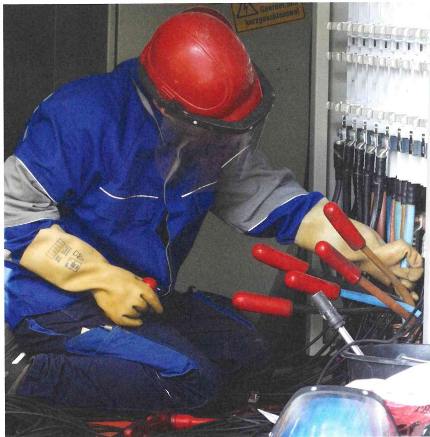
Einbau der Überwachungstechnik in der Trafostation beim Pilotprojekt der Stadtwerke Saarbrücken Netz AG. Bild: co.met
