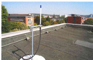
LoRaWAN-Antenne auf einem Gebäude der Stadtwerke Saarbrücken. Die co.met GmbH sorgt in der saarländischen Landeshauptstadt flächen-deckend für IoT-Konnektivität und stellt ihr Know-how anderen Versorgern zur Verfügung. Bild: co.met
